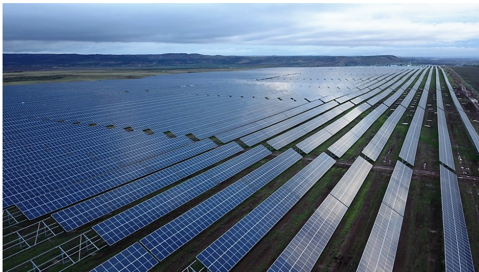
Planta fotovoltaica Carpio De Tajo en Toledo
